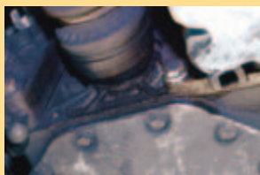
Zdarzają się wycieki z wewnętrznych przegubów
